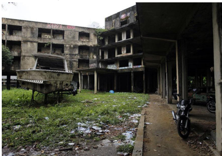
Figura 7: Prédio abandonado em Manaus
