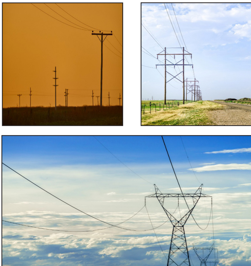
Figura 1 – Imagens de fios que conduzem eletricidade
