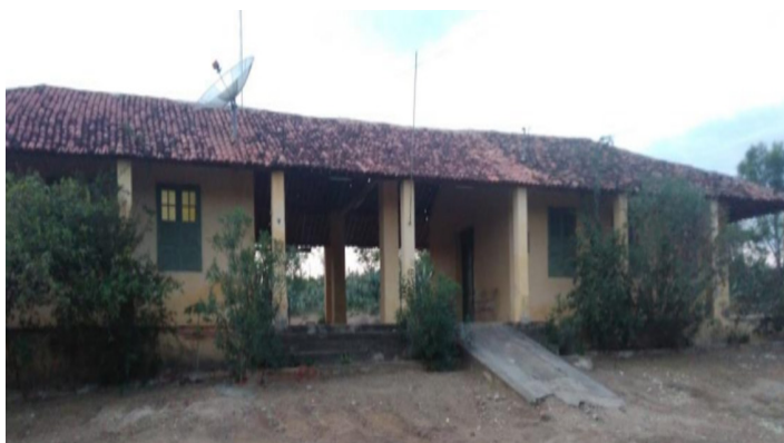
Figura 2: Prédio da extinta Escola Mínima Chéus, localizada no Distrito de Chéus – Surubim-PE
